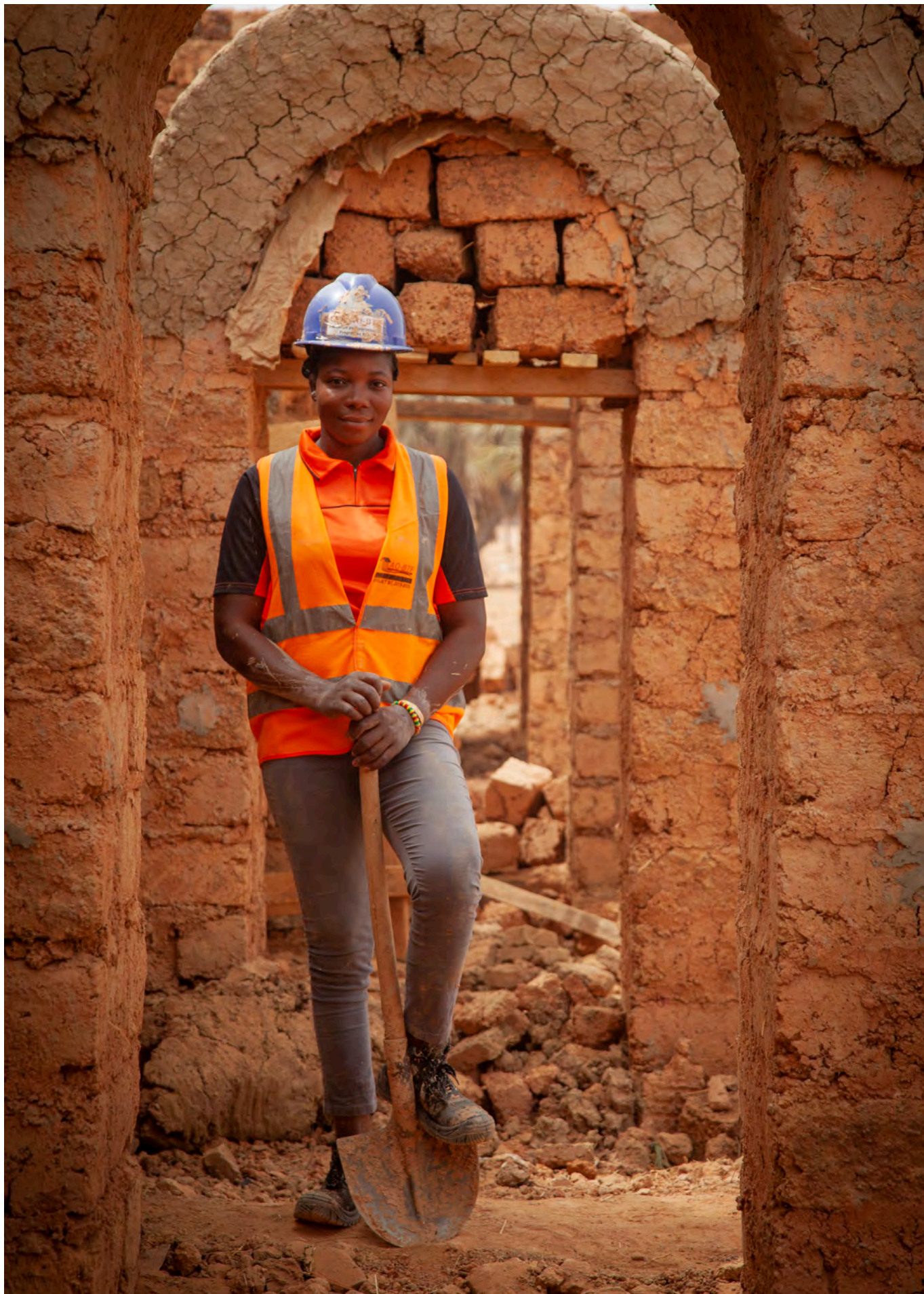
Une jeune burkinabé sur un chantier de construction, apprenant le métier de maçonnerie. © Aboni.
